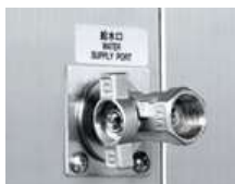
純水供給口(減圧弁付)
