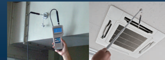
空調機器の能力試験・保守点検
