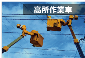
架空配電線/送電線
